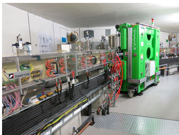
Wnętrze tunelu pierścienia akumulacyjnego w NCPS SOLARIS
